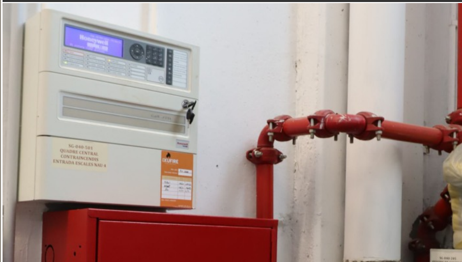
Instal·lacions i centrals detecció incendis
