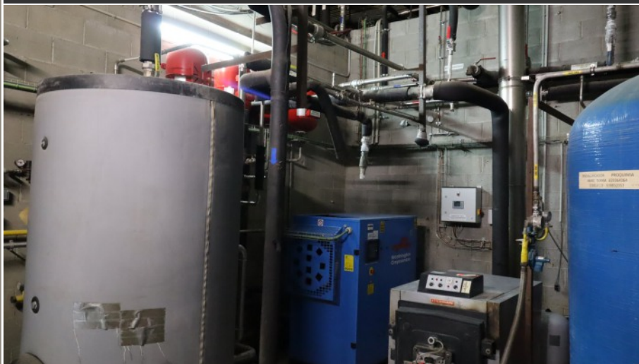
Zona descalcificadors + acumulador ACS 2.000L
