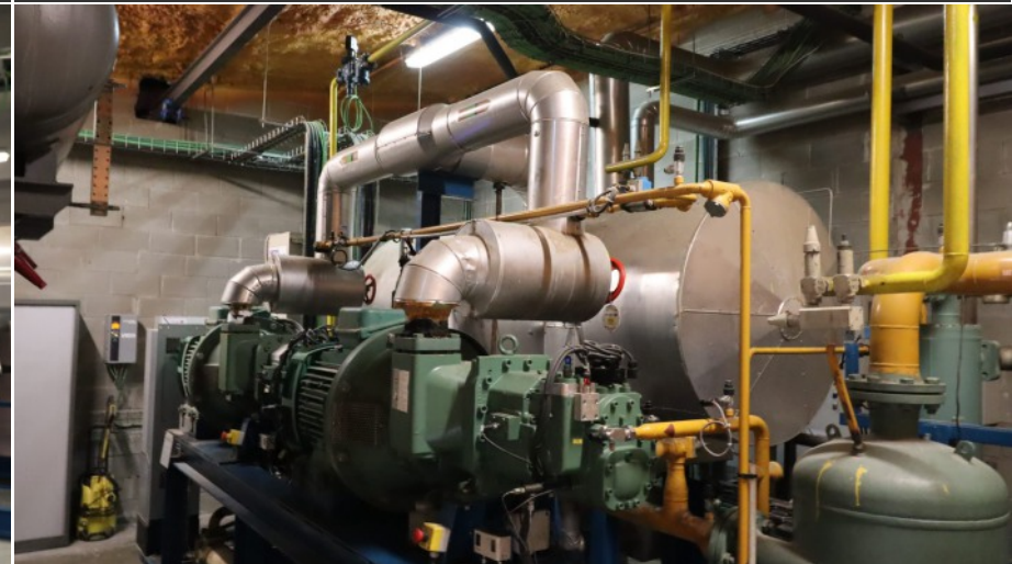
Central frigorífica amoniac nau principal
