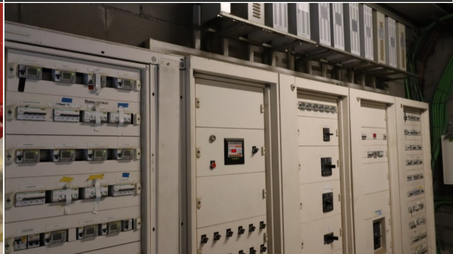
Central elèctrica nau principal
