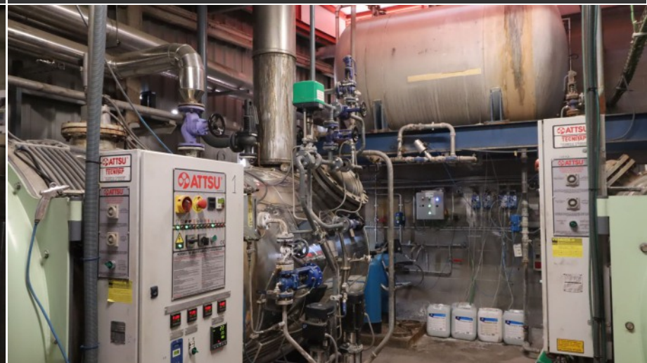
Sala calderes producció vapor
