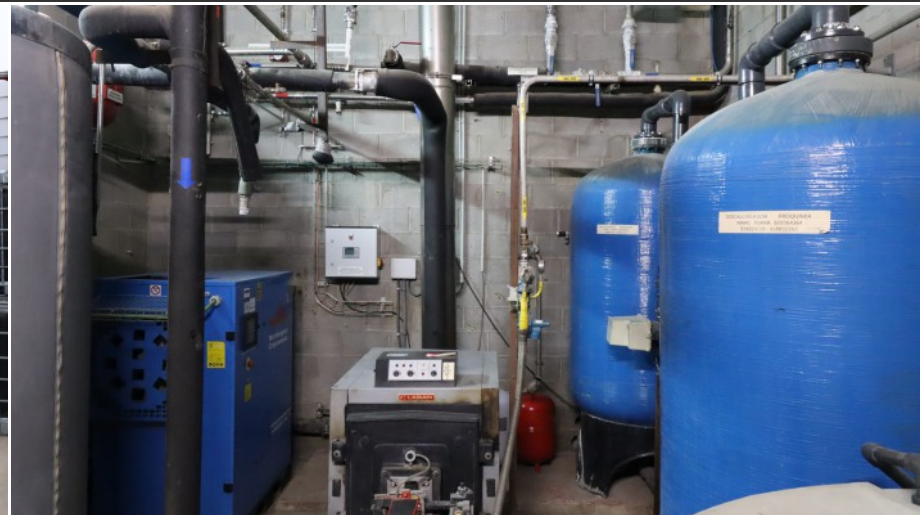
Zona descalcificadors + caldera gas nat ACS
