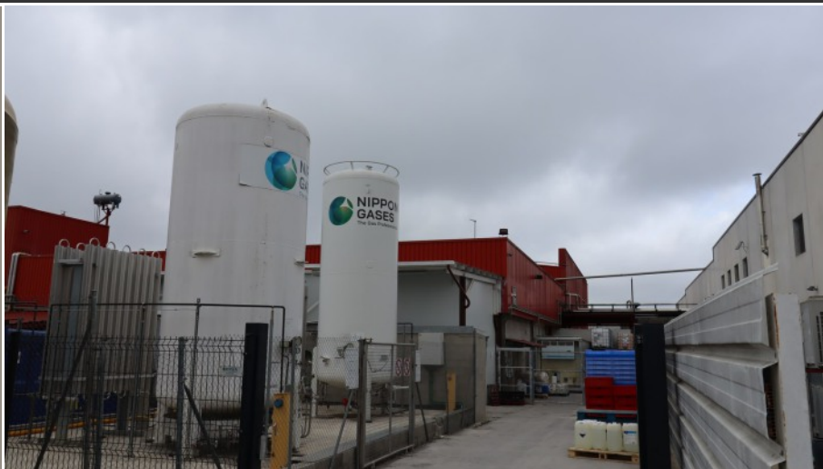
Pati darrera, dipòsits gas inert (envasar)
