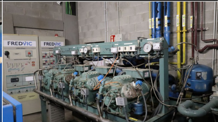
Central frigorífica per sales - gas freon
